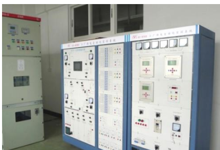
工厂供配电及电力系统自动化实验室
